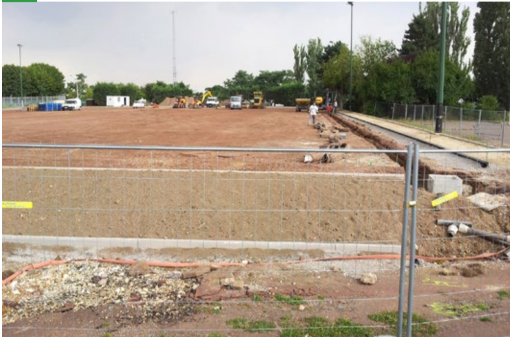
Réalisation du terrassement en déblais et remblais qui fera office de fond de forme.
